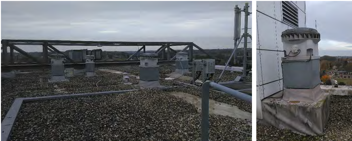
Dakverdieping: mechanische afzuiging
