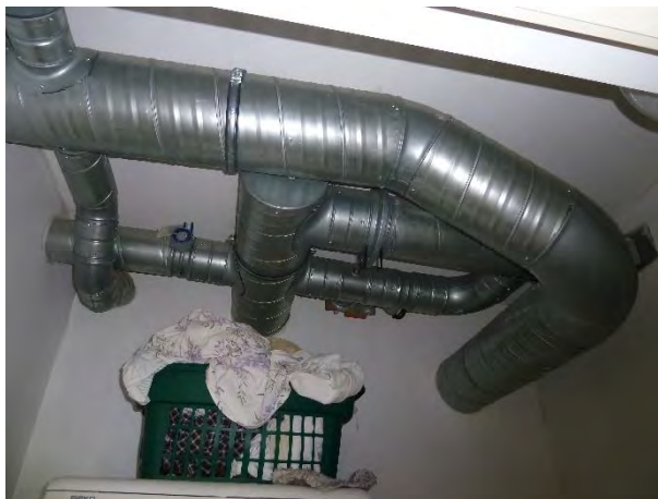
Berging: ventilatiebuizen in appartement
