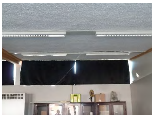
Gordijnen ten zuiden zijn niet bedienbaar
