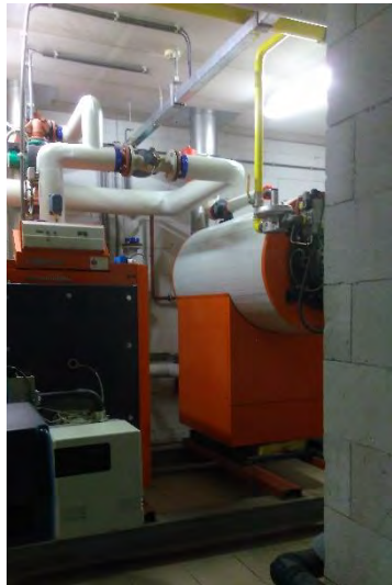
Centrale stookplaats op dakverdieping
