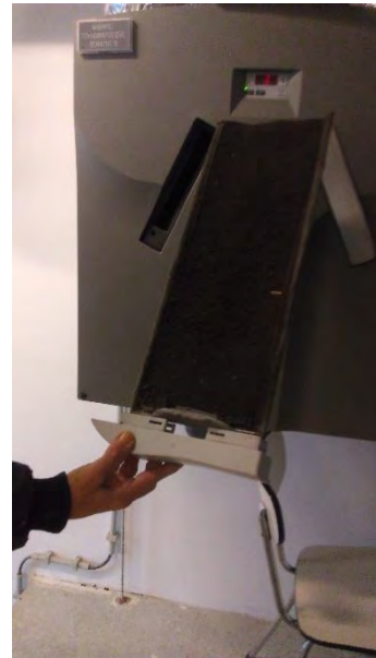
vervulde filter (warmtewisselaar)
