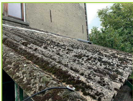
Asbestcementen golfplaten (mèt bijhorend mos en/of de wortels van klimop)
