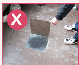
Vinyltegels (vloertegels en vloerzeil uit asbesthoudend vinyl)
