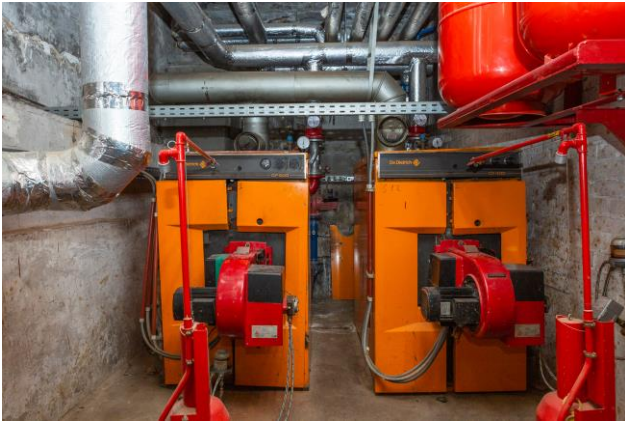
Figuur 23: Voorbeeld van een stooklokaal met stookketels
