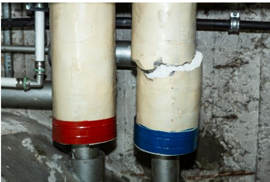
Figuur 57: Voorbeeld van thermische leidingisolatie in gips
