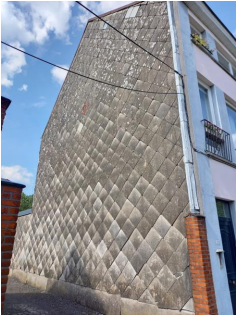
Figuur 48: Voorbeeld van verweerde gevelleien in vezelcement
