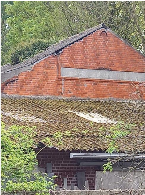
Figuur 49: Voorbeeld van verweerde golfplaten in vezelcement
