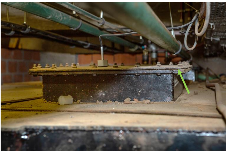
Figuur 51: Voorbeeld van een mangatdeksel van een stookolietank, met mogelijke dichting type "Klingerit"
