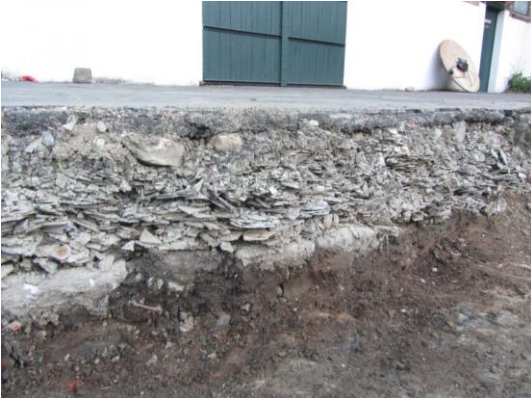
Figuur 33: Voorbeeld van een normaliter niet-waarneembare ophooglaag met stukken in vezelcement. Wel waarneembaar indien bestaande opening.
