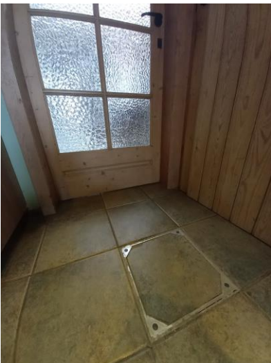
Figuur 31: Voorbeeld van niet-waarneembare ruimte onder vastgeschroefd putdeksel
