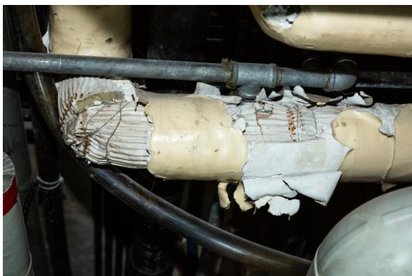
Figuur 58: Voorbeeld van thermische leidingisolatie in gips
