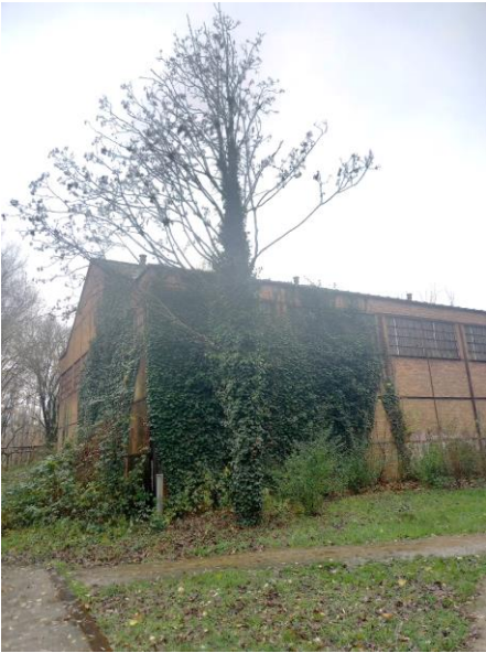
Figuur 40: Voorbeeld van overwoekerende vegetatie aan gevels
