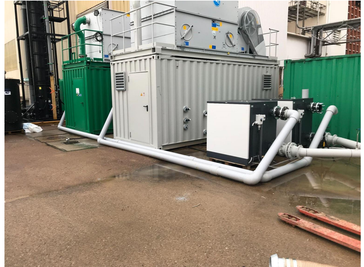
2 Bodemluchtventilatoren en koelers
