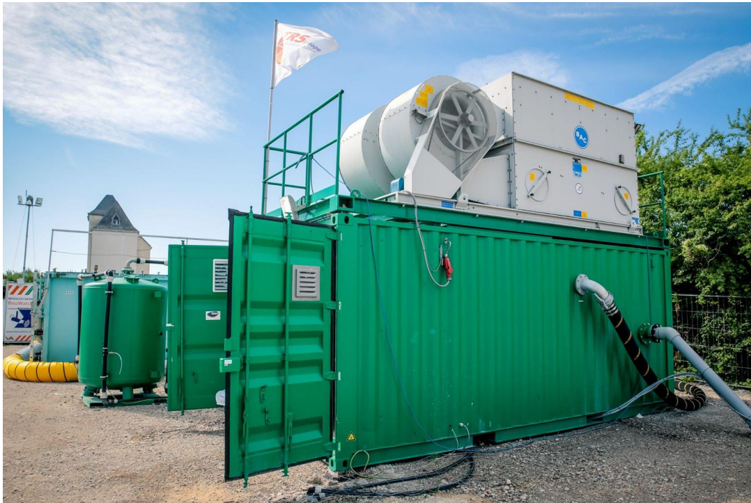
Koeler voor afgezogen dampen (steam condenser)
