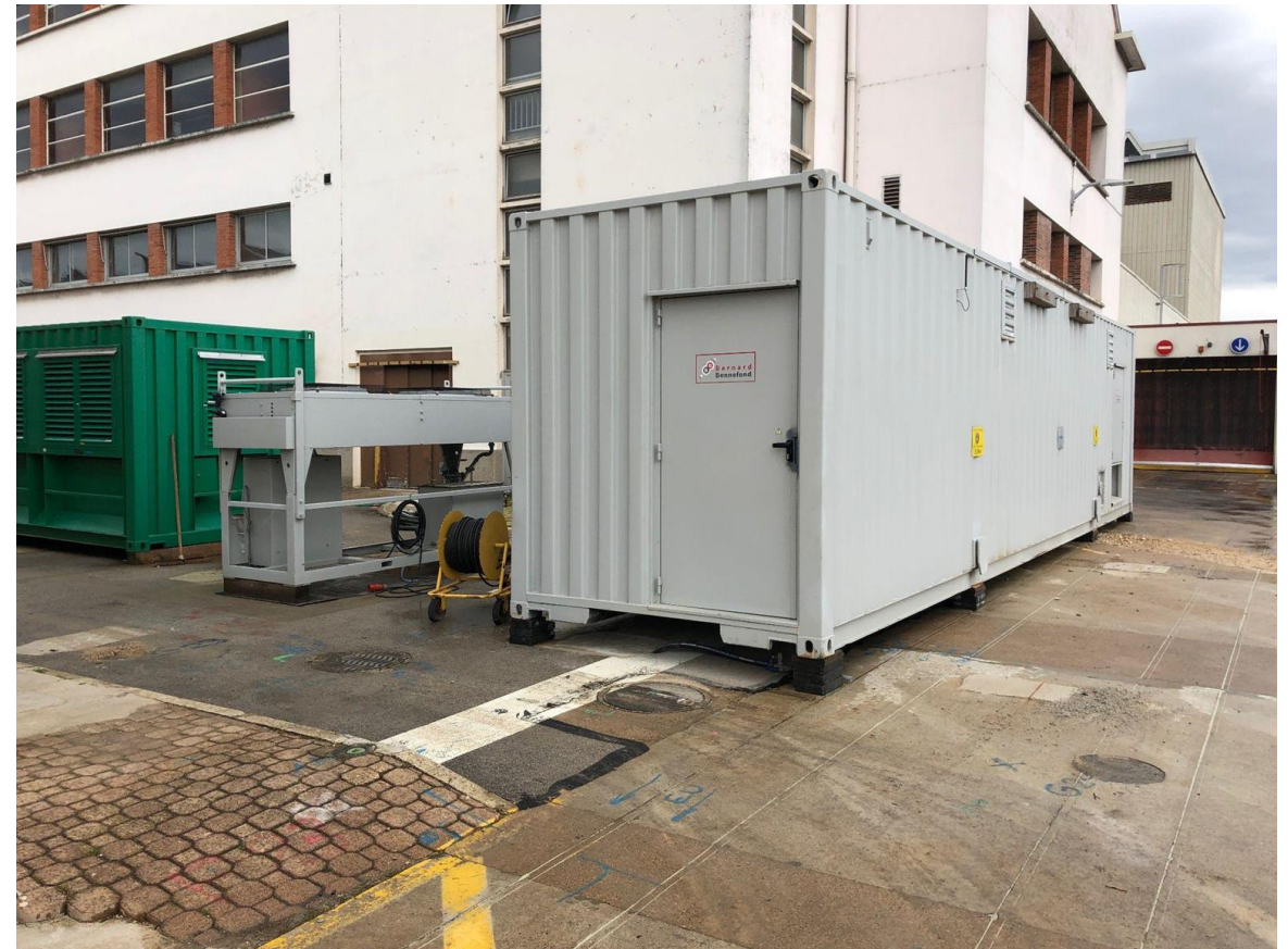
Hoofdtransformator + koeler (Power Control Unit)
