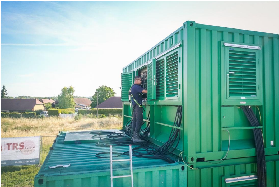
Transformatoren voor verlagen spanning (Step Down Transformer)
