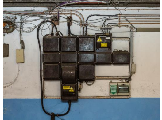
Figuur 4242: Voorbeeld van bakelieten elektriciteitskasten
