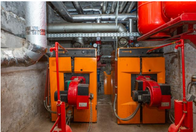
Figuur 2831: Voorbeeld van een stooklokaal met stookketels
