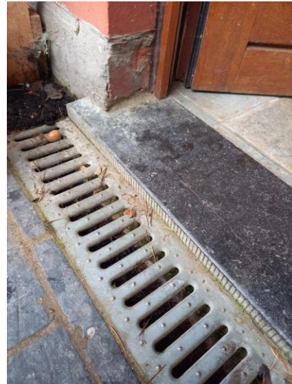
Figuur 4: Voorbeeld van een waarneembare ruimte onder losliggend rooster.
