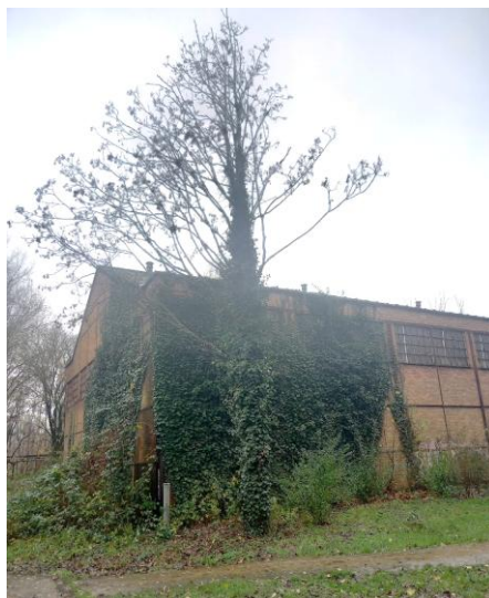
Figuur 3234: Voorbeeld van overwoekerende vegetatie aan gevels
