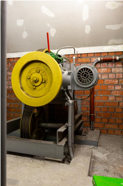
Figuur 3739: Liftmachine: uit het onderhoudsdocument, dat als bewijsdocument geldt, staat dat de remschoenen vervangen werden in 2016
