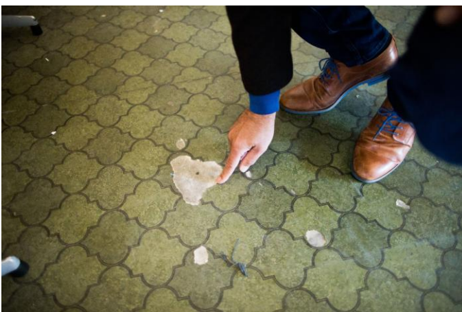
Figuur 4951: Voorbeeld van vinylvloer met onderlaag in asbestkarton
