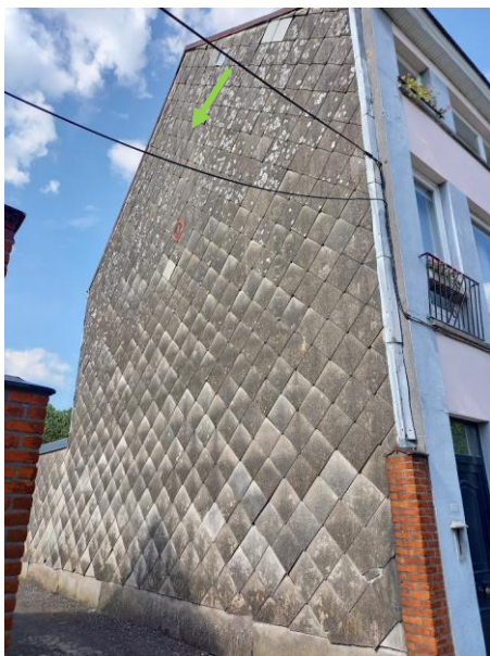
Figuur 63: Voorbeeld van verweerde gevelleien in vezelcement
