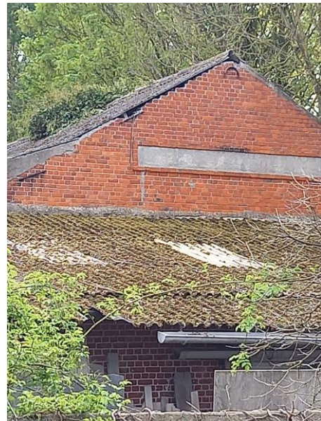
Figuur 64: Voorbeeld van verweerde golfplaten in vezelcement
