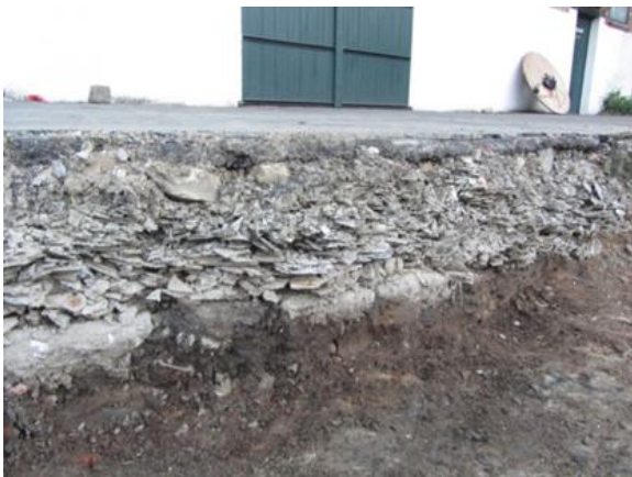
Figuur 1: Voorbeeld van een ophooglaag met stukken vezelcement die in normale omstandigheden niet waarneembaar is.
