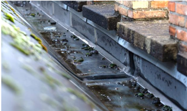
Figuur 44: Voorbeeld van sediment in een dakgoot, afkomstig van leien als dakbedekking
