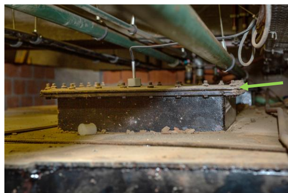
Figuur 66: Voorbeeld van een mangatdeksel van een stookolietank, met mogelijke dichting type "Klingerit"
