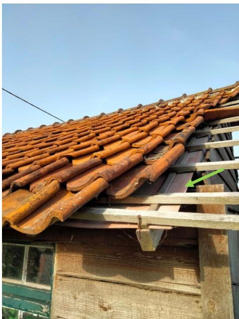
Figuur 53: Voorbeeld van niet-eenvoudig bereikbare onderdakplaten
