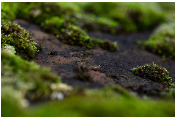
Figuur 55: Voorbeeld van vrijkomende chrysotielvezelbundels door degradatie (mos) van leien in vezelcement
