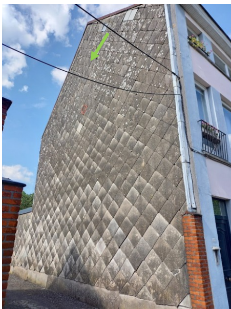
Figuur 57: Voorbeeld van verweerde gevelleien in vezelcement
