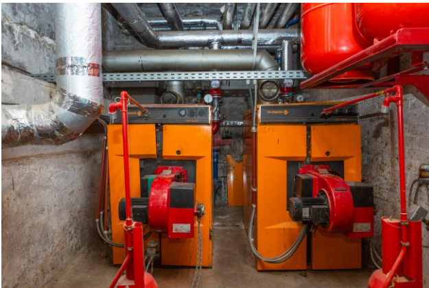
Figuur 27: Voorbeeld van een stooklokaal met stookketels
