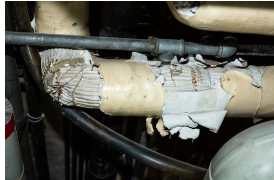
Figuur 50: Voorbeeld van thermische leidingisolatie in gips
