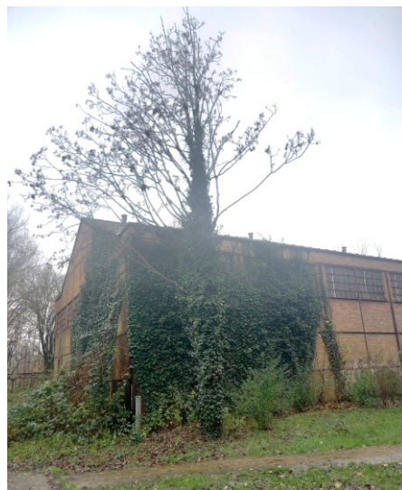
Figuur 31: Voorbeeld van overwoekerende vegetatie aan gevels
