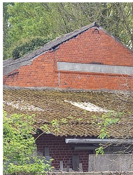
Figuur 58: Voorbeeld van verweerde golfplaten in vezelcement
