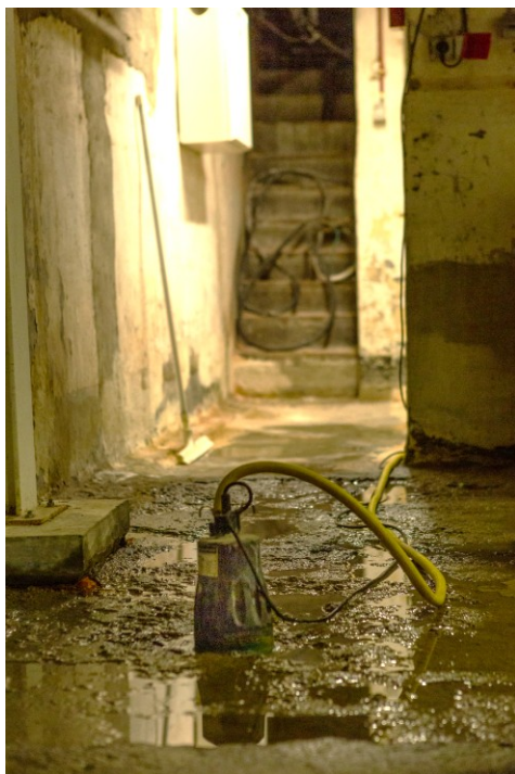
Figuur 32: Voorbeeld van een opgeheven tijdelijke onderzoeksbeperking: water in kelder weggepompt met pomp
