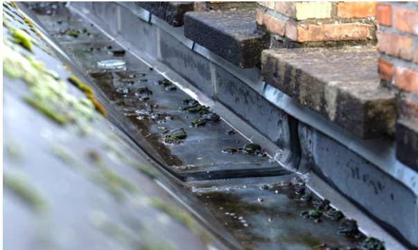
Figuur 43: Voorbeeld van sediment in een dakgoot, afkomstig van leien als dakbedekking
