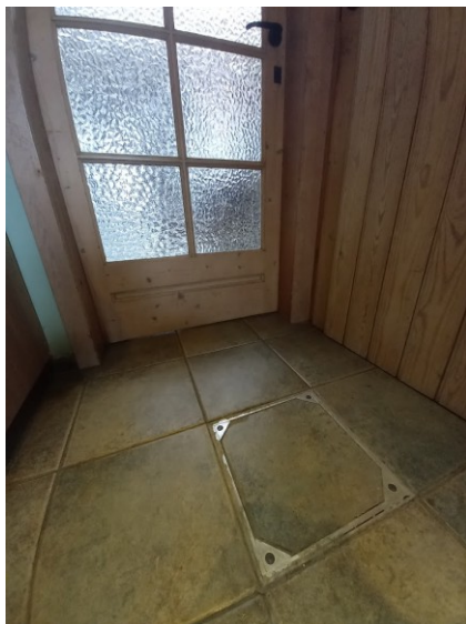
Figuur 3: Voorbeeld van een niet-waarneembare ruimte onder vastgeschroefd putdeksel.
