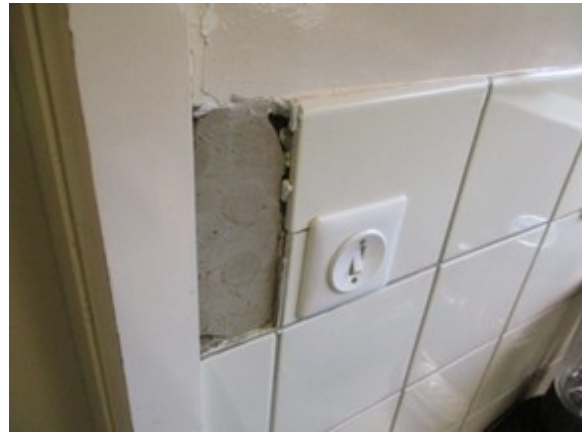
Figuur 2: Voorbeeld van tegellijm achter faience tegels die in normale omstandigheden niet-waarneembaar is. De tegellijm is hier wel waarneembaar door de bestaande opening (beschadiging van de tegels).
